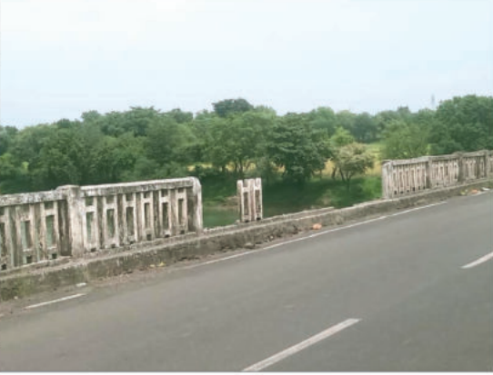
झाबुआ –रतलाम जिले को जोड़ने वाली माही नदी के पुल की जर्जर स्थिति ।
