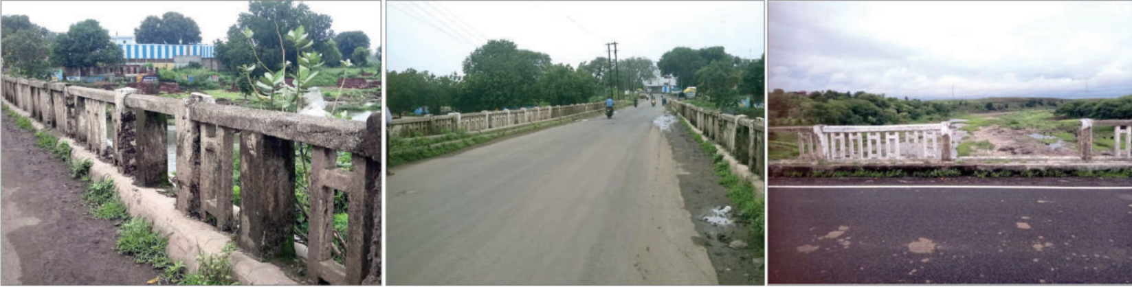
पम्पावती नदी पेटलावद का वर्षा पुराना जर्जर पुल और जर्जर रेलिंग ।
